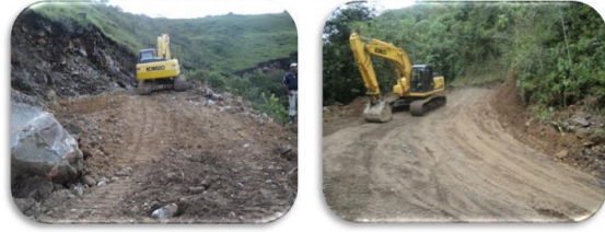
Tipo de intervención rehabilitación y reapertura de vía El Vegón – Lagunitas municipio de Recetor
