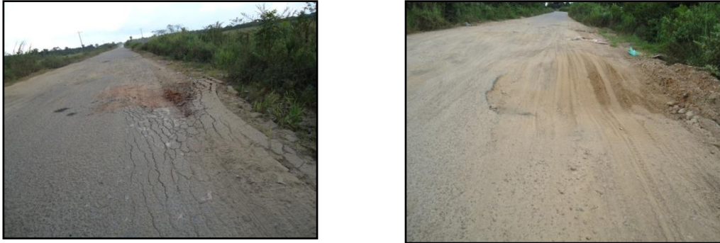
Foto 1. Fallos asociados a falla por capacidad portante
