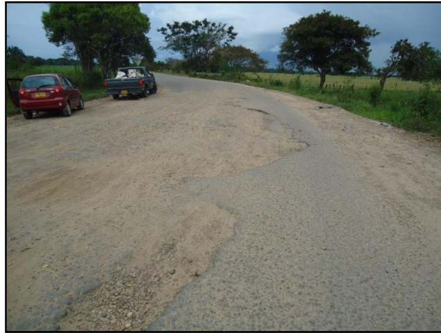
Foto 3. Fallo asociado a Falla estructural por doble repetición de carga
