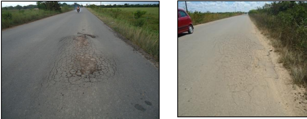
Foto 2. Fallos asociados a falla estructural
